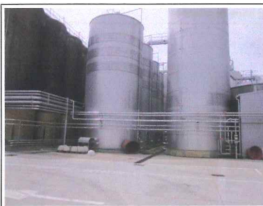
Cuves de stockage extérieures
