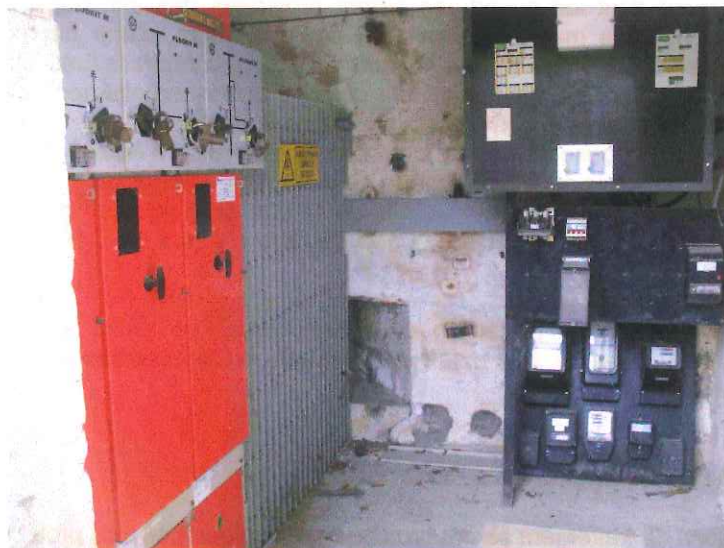
Fig 3 :: installations électriques inondables (le plancher du local est celui de la fig2)
