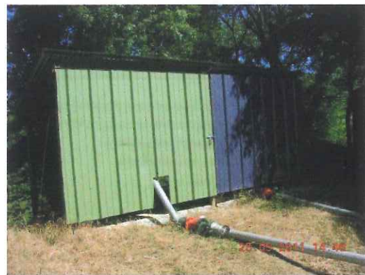
Station de pompage pour irrigation (P4)
